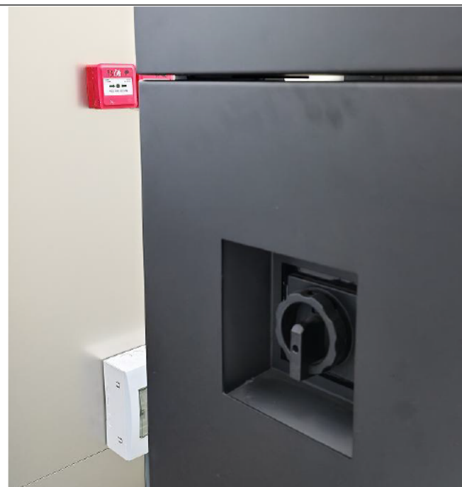
Metrotom 1500 225kV G3型工业CT左侧总电源开关
