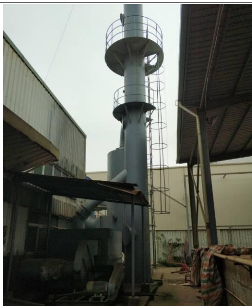
熔炼炉车间废气处理装置
